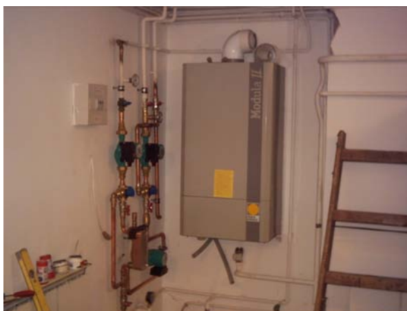
3.sz. kép kazánházi munkálatok: a gázkazán beépítése és a kétkörös fűtési rendszer kiépítése
