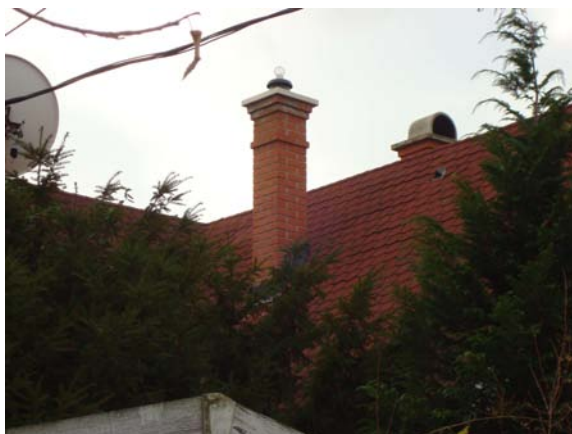
6.sz.kép kémény kondenzációs kazánhoz
